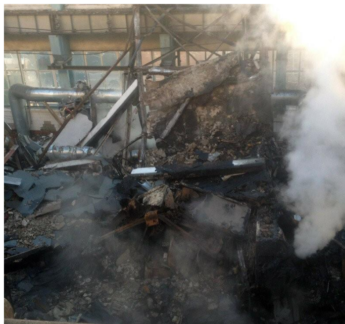
Рисунок 1.13 – Последствия пожара на Курской газораспределительной станции
